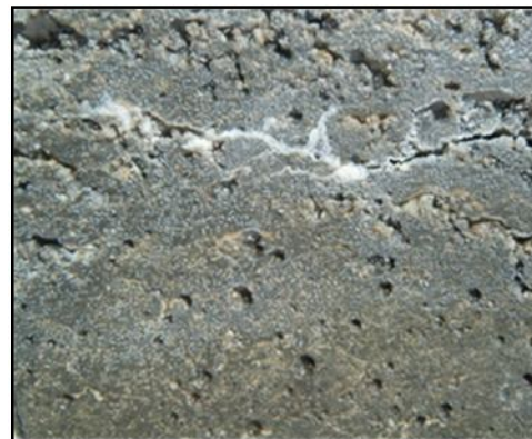
(الف) تصویر ترک ترمیم یافته در بتن با بدون بزرگنمایی
